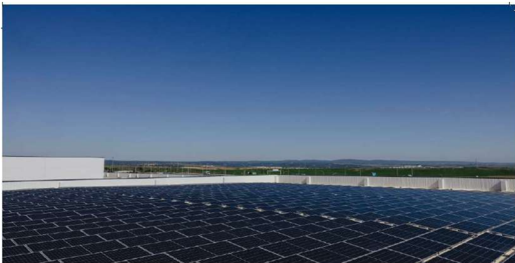
Instalaciones fotovoltaicas en la cubierta del nuevo Centro Logístico.
