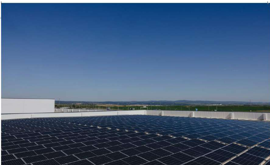
Instalaciones fotovoltaicas en la cubierta del nuevo Centro Logístico.
